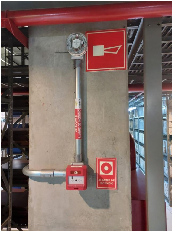
Foto 13: Dentro da Reserva técnica: Sistema de Detecção e Alarme de Incêndio
